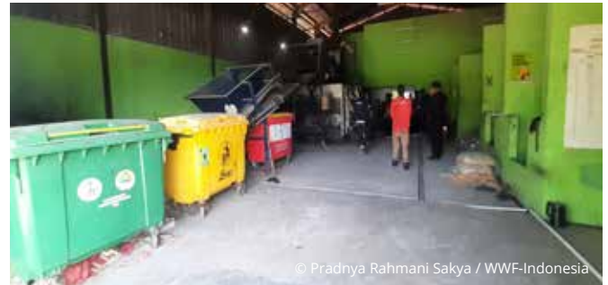
Gambar 42. Insenerator TPS 3R Pulau Tidung
